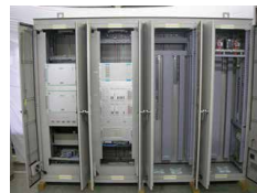
ガスタービン制御盤
