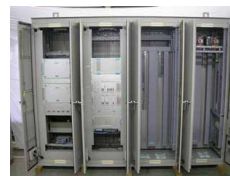
ガスタービン制御盤
