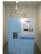
放射性廃液処理装置
