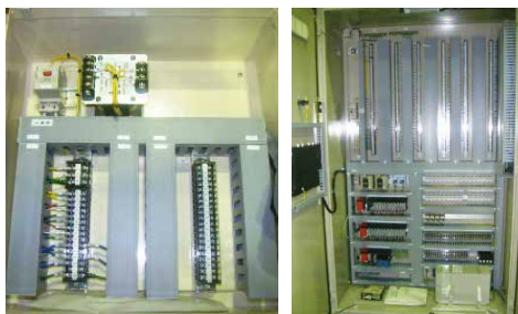
盤温・湿度監視盤 (内部)
