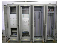
ガスタービン制御盤
