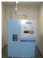
放射性廃液処理装置
