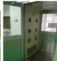
工場内入口エアージャワー
